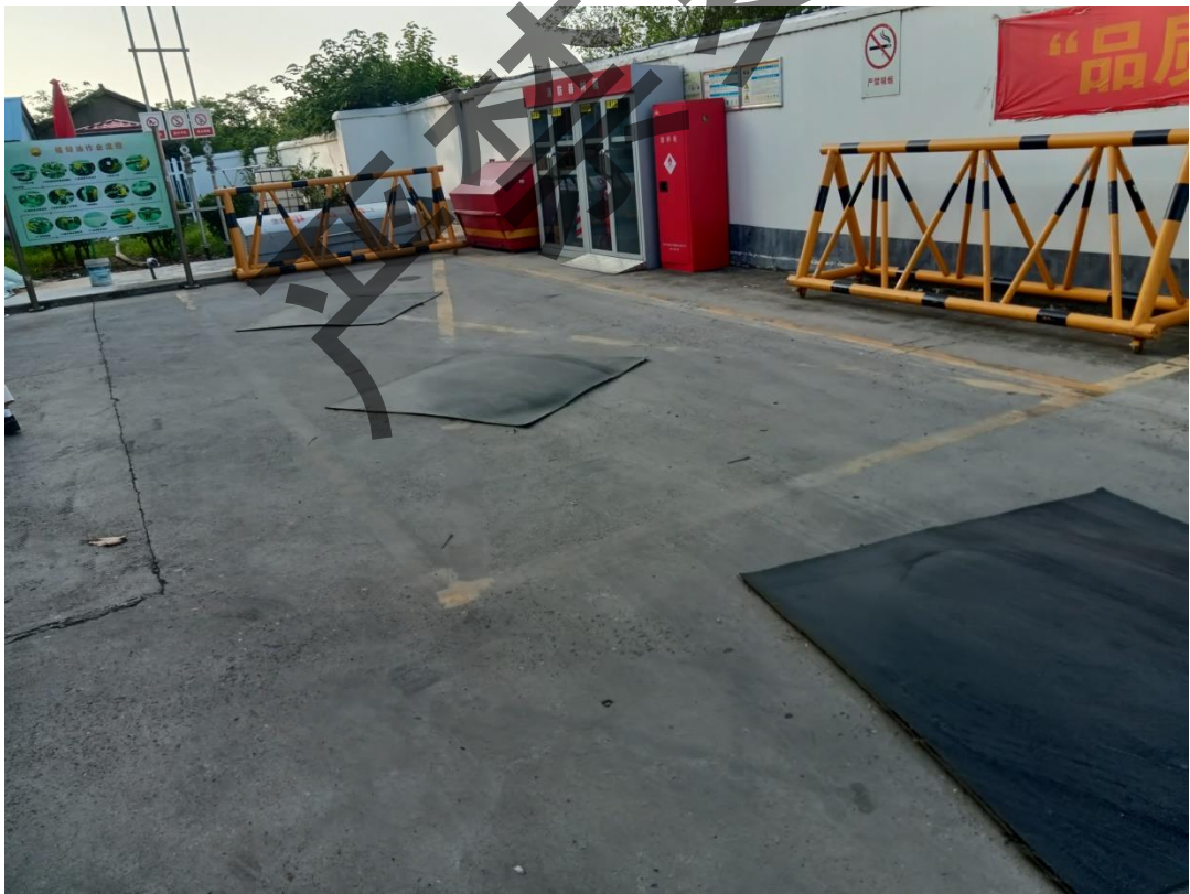
加油站罐区照片
