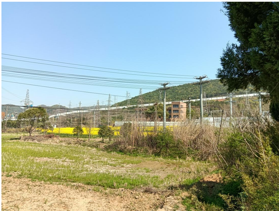
图 2-8 加油站西侧架空电力线路
