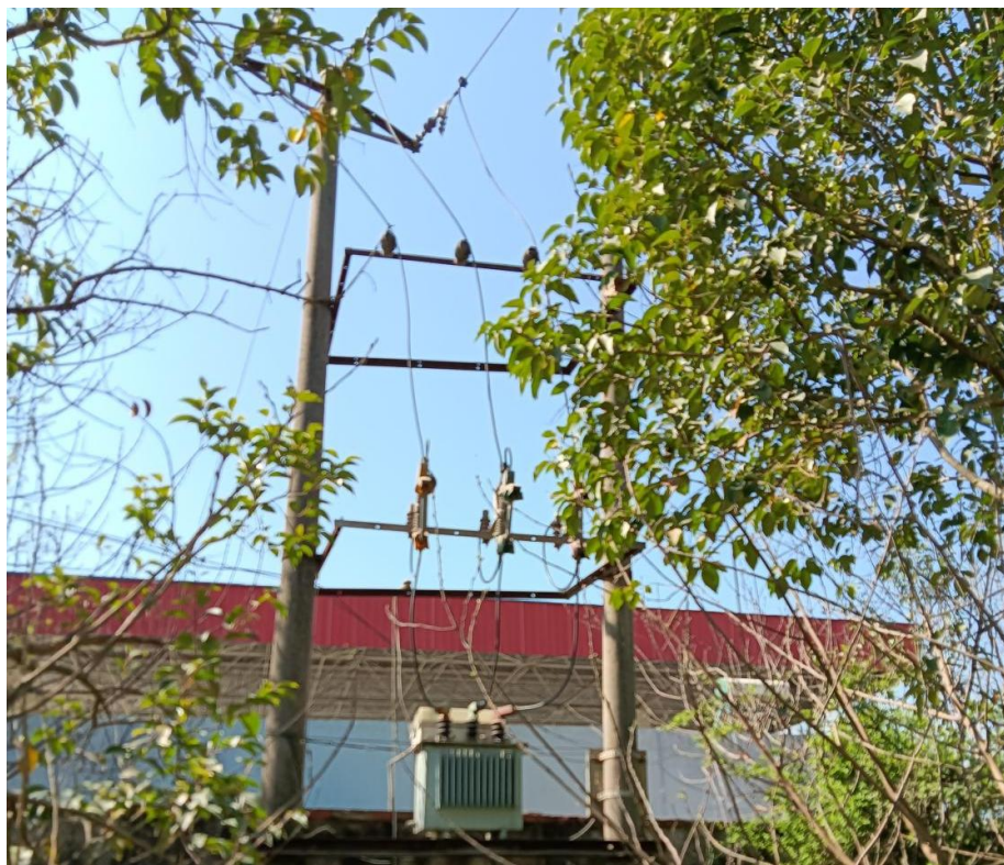
图 7 项目北侧变压器和架空电力线路
