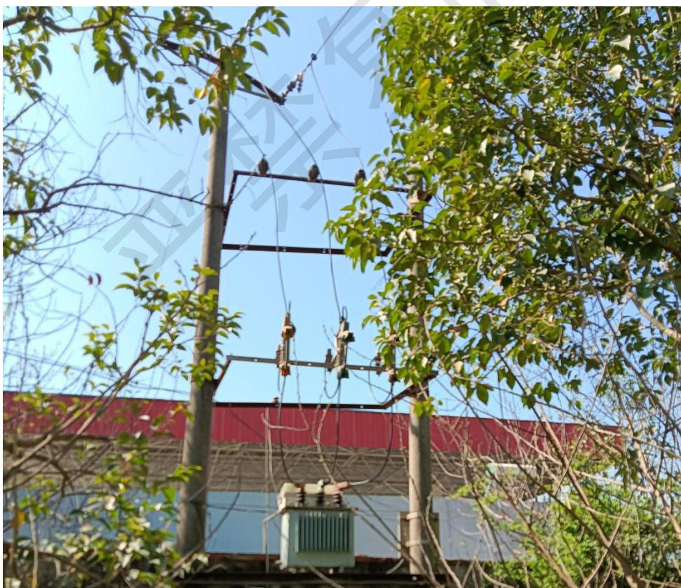
图2-9 加油站北侧变压器和架空电力线路
