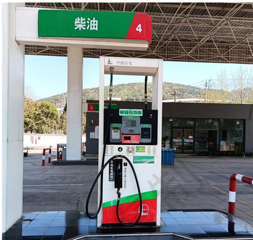
图 2-11 加油站加油机照片
