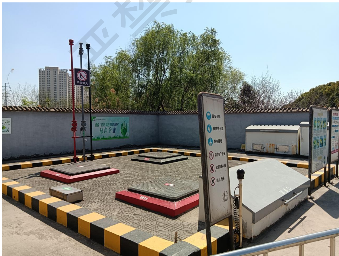
加油站罐区照片
