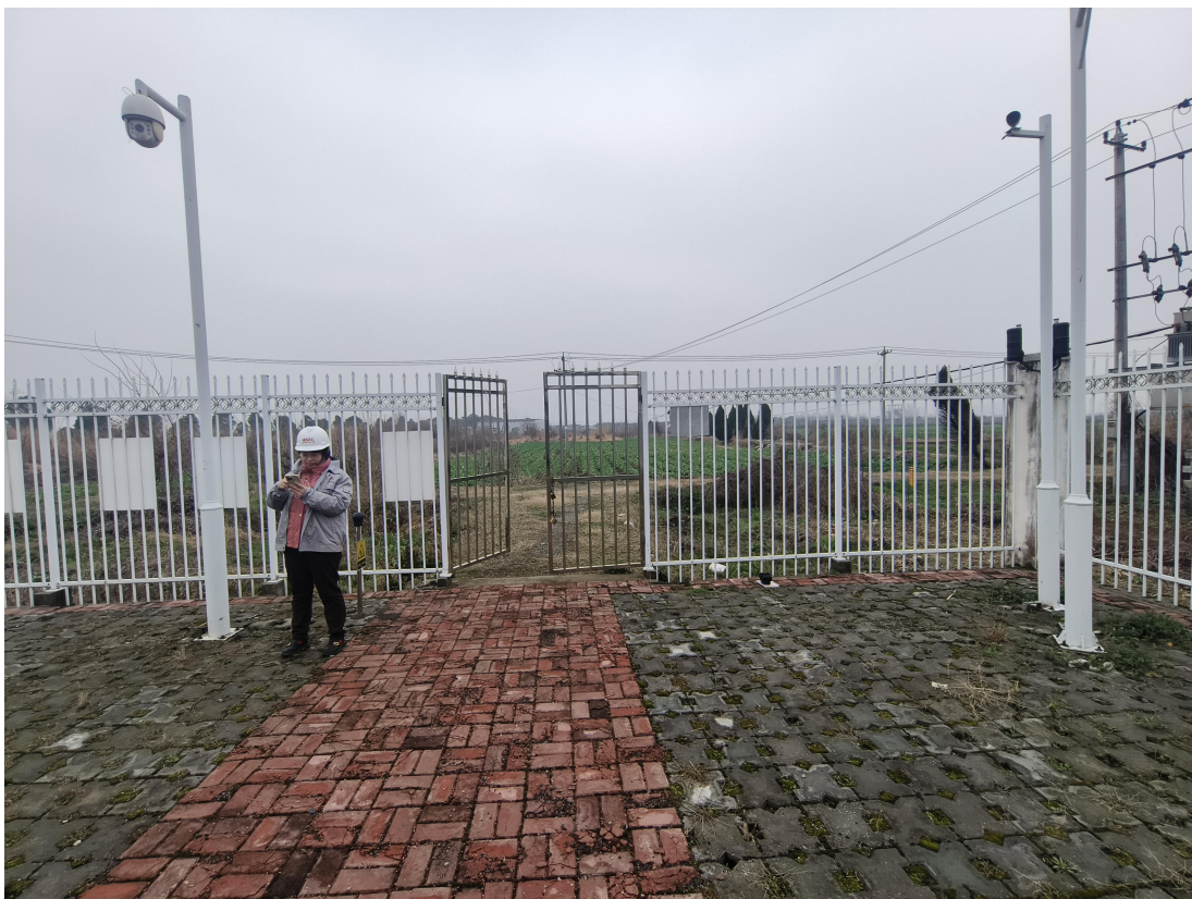
海口调压站北侧入口
