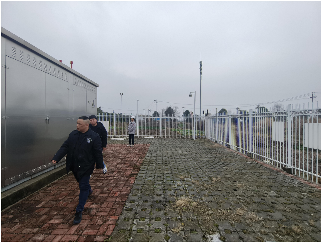
海口调压站南侧
