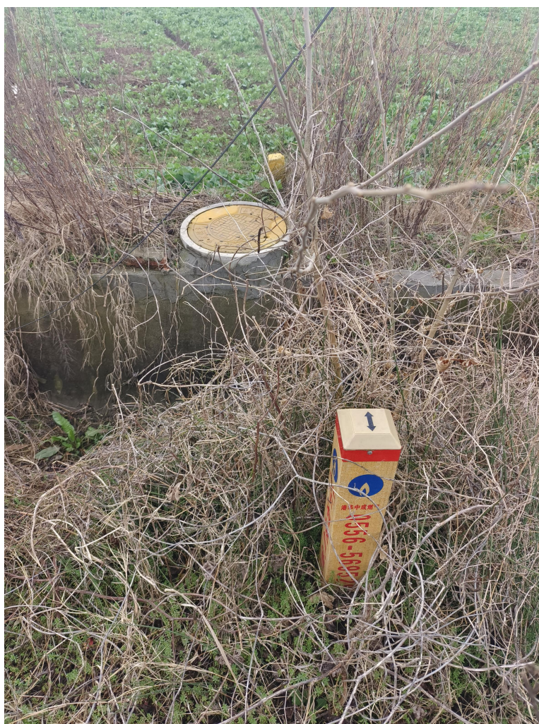
出调压撬中压管线阀门井
