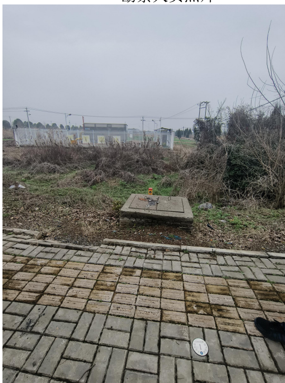
海口调压站南侧（出站中压管线阀门井）
